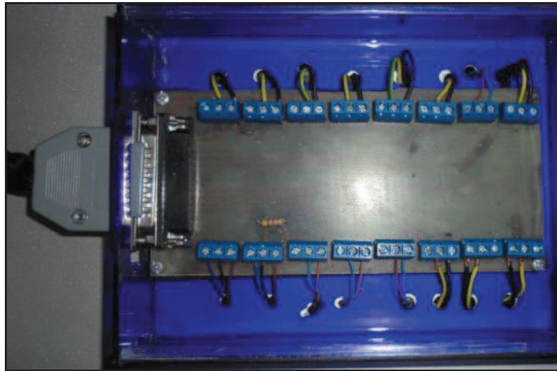
Figura 4.97 Tarjeta principal de comunicación PLC – Proceso Fuente: Propia del tutor
