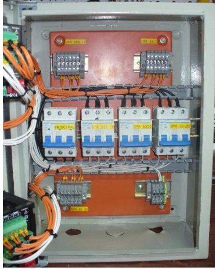
Figura 3. 11: Panel Auxiliar de Analizadores de Red
