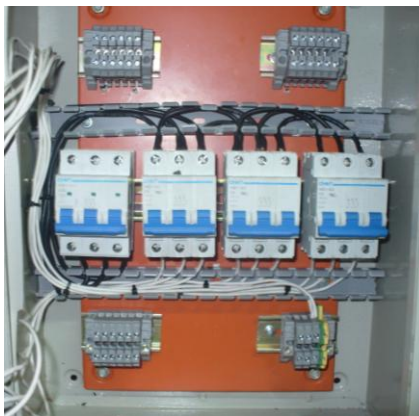
Figura 3. 10: Breakers trifásicos en panel auxiliar
