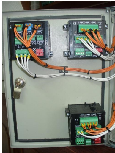
Figura 3. 16: Conexión de Voltaje y Corriente en Analizadores de Red
