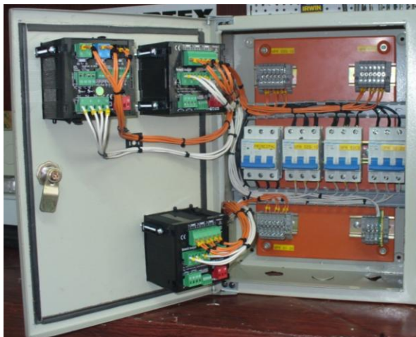
Figura 3. 19: Panel de Analizadores de Red
