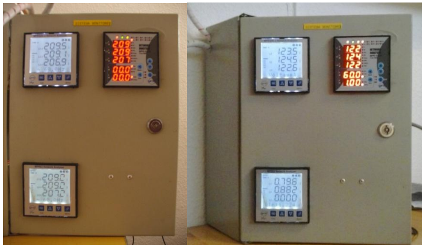
Figura 4. 6: Visualización de voltajes y corrientes en analizadores de red
