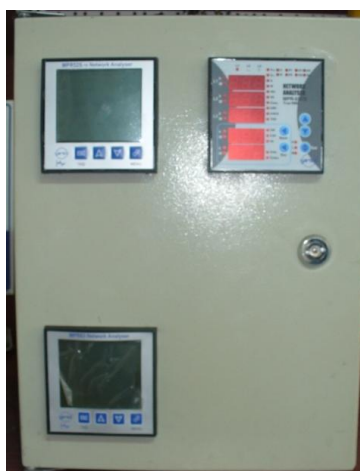
Figura 3. 20: Panel de Analizadores de Red - Vista Frontal
