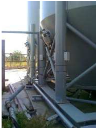
Figura 2.8 Sensores fácilmente acoplados a los soportes de la estructura del silo.
