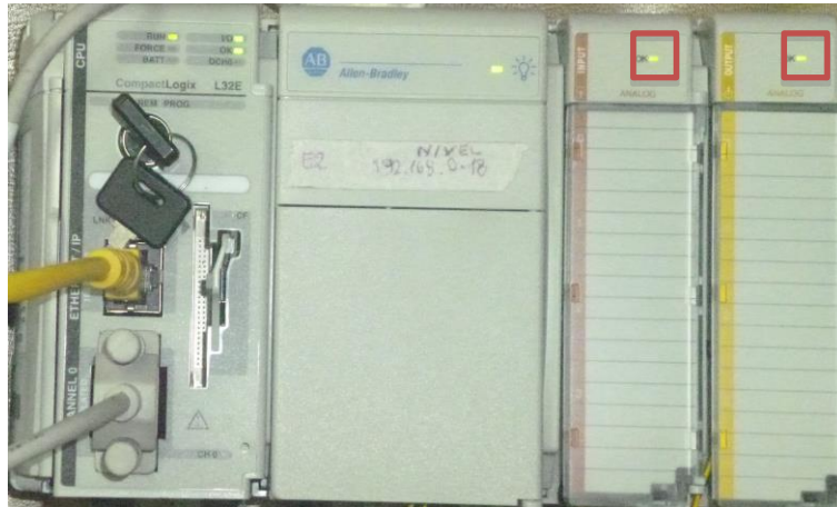
Figura 3.2: Leds indicadores de que los módulos están funcionando correctamente.
