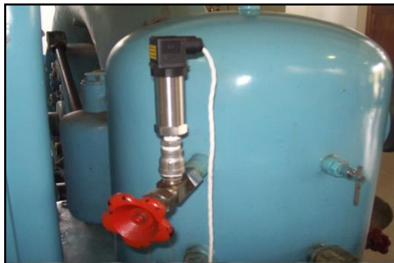
Figura 4. 12: Sensor de presión ubicado en el tanque de presión hidráulica
