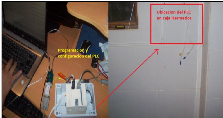
Figura 4. 9: Instalación del PLC en el cuarto de control
