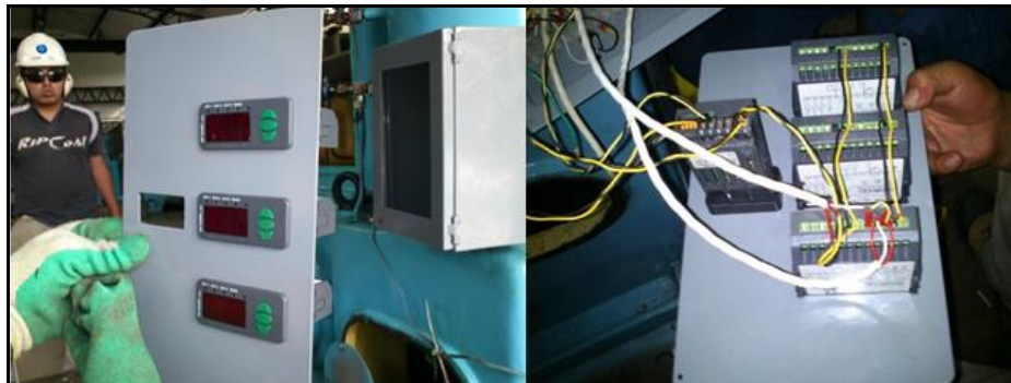
Figura 2. 10: Instalación de los controladores en la caja hermética
