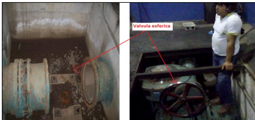
Figura 1. 19: Válvula esférica de apertura y cierre de la central Hidroeléctrica Catazacón
