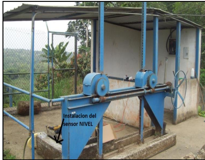
Figura 4. 5: Ubicación de sensor de nivel de agua en el tanque de presión
