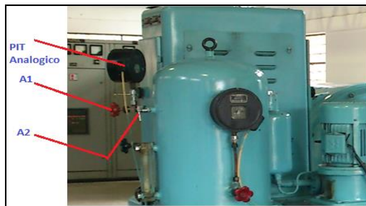
Figura 2. 17: Instalación de Trasmisor de presión en el sistema de regulación de velocidad
