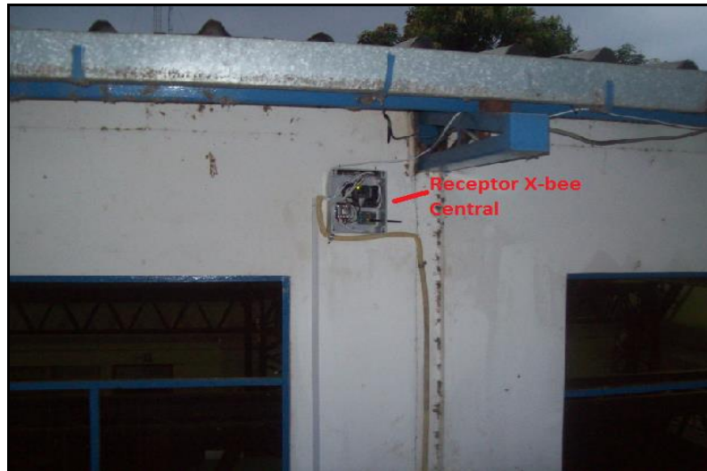
Figura 4. 8: Receptor ubicado en dirección hacia en transmisor ubicado en el tanque de presión
