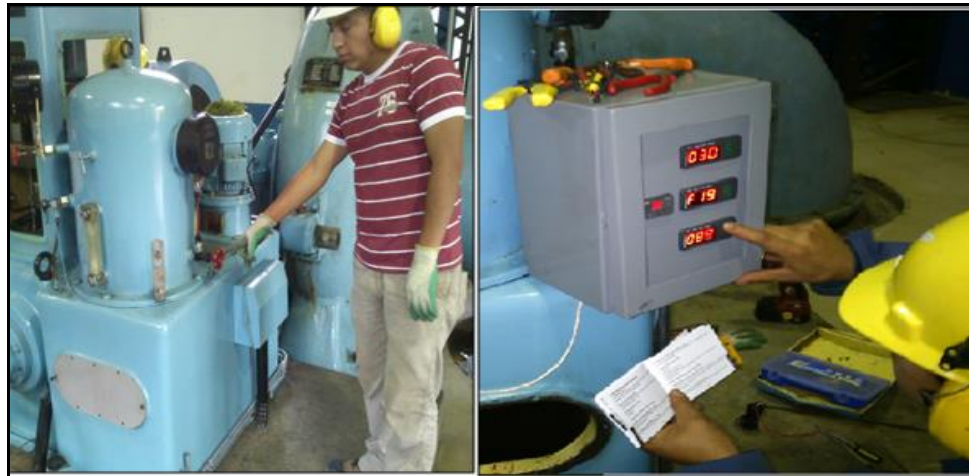
Figura 4. 2: Encendido de los medidores-controladores de temperatura
