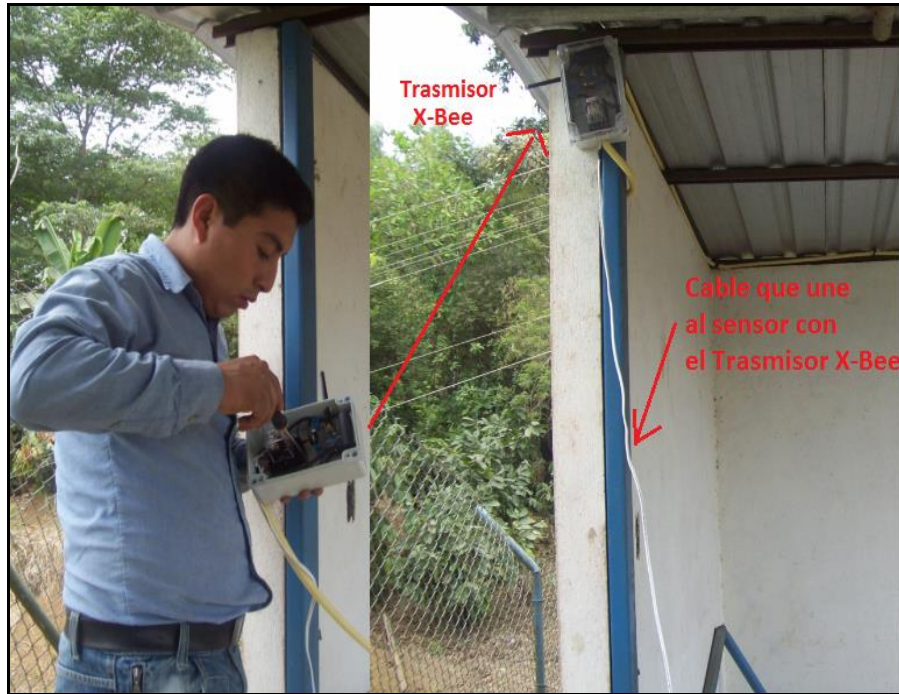
Figura 4. 6: Instalación del trasmisor X-Bee en el tanque de presión
