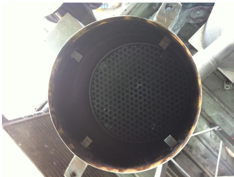
Fig. 136 Interior filtro de gas.
