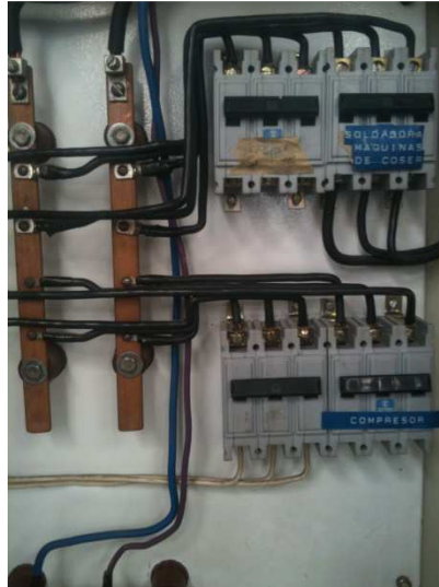
Figura. 4.11. Tablero de Distribución.
