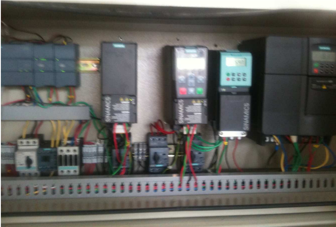
Figura. 4.8. Gabinete del Sistema de Control
