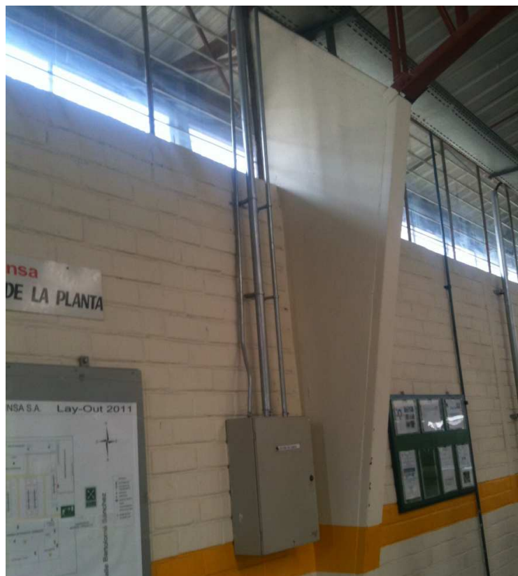
Figura. 4.12. Ruta del Cableado hacia la Máquina Dosificadora.
