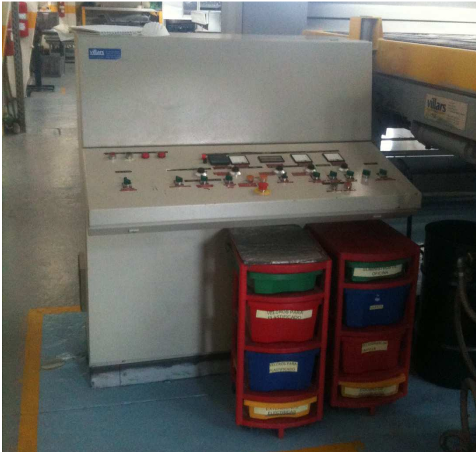
Figura.4.7. Tablero de Control de la Máquina Dosificadora.
