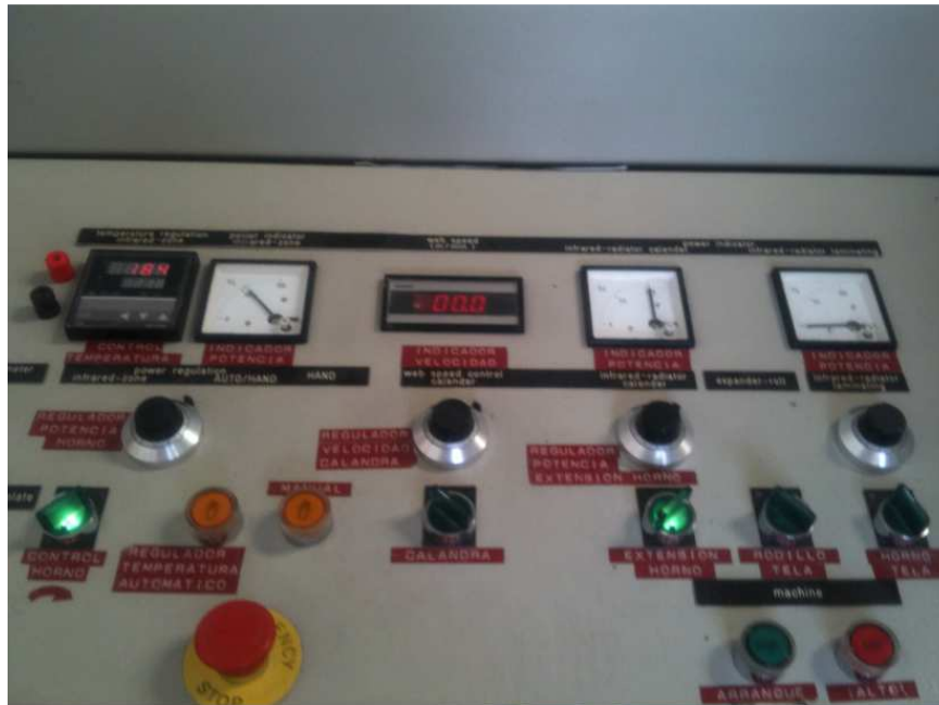
Figura. 4.34. Tablero de Control de la Máquina Dosificadora.
