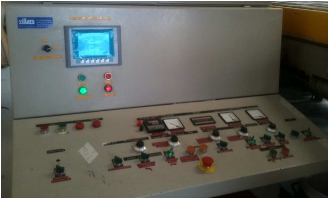
Figura. 4.9. Tablero de Control
