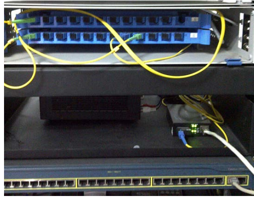
Figura 4.6: Instalación equipo WDM en el Headend. Realizado por: El investigador.
