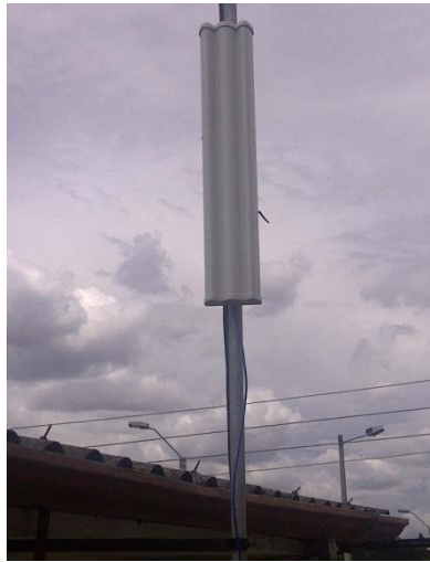
Figura 4.8: Instalación equipo AP WiFi.
