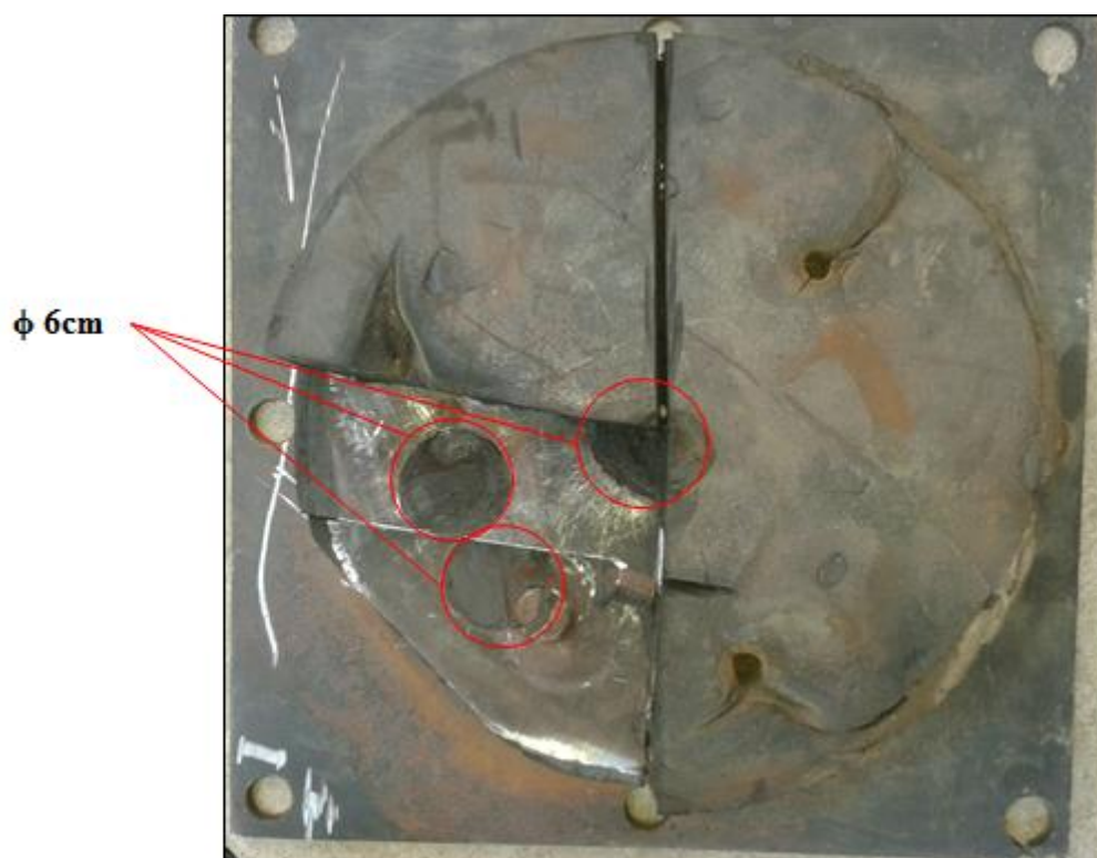
Figura 23 Orificios en las placas de acero internas del Aislador.
