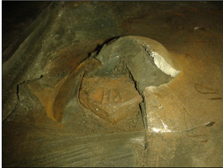
Figura 25 Rotura presente en la lámina 2 de refuerzo.
