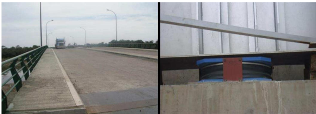
Figura 7 Puente Norte con Aisladores Elastoméricos FPS
