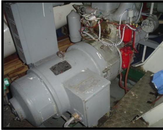
Figura 1-4 Generador de emergencia Fuente: ( Manual de Ingeniería; Armada del Ecuador)
