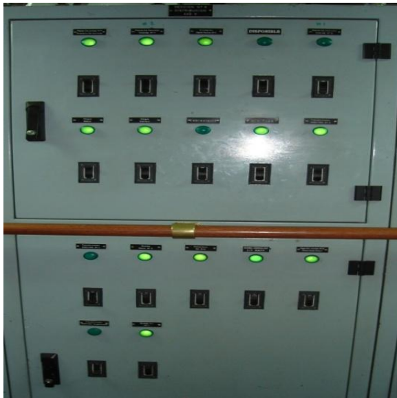
Figura 3-28 Tablero#6 440V Fuente: (CD de memorias del Buque Escuela Guayas, 2005)
