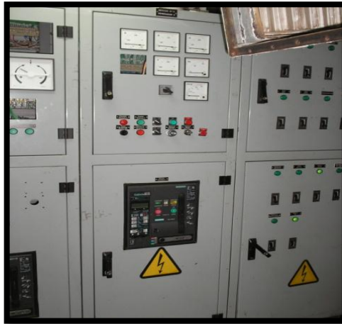
Figura 3-22 Vista lateral del tablero del generador#2 y generador#1
