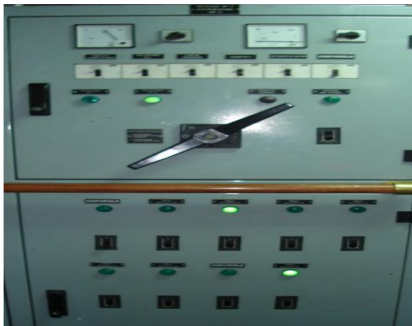
Figura 3-31 Tablero#7 110V Fuente: (CD de memorias del Buque Escuela Guayas, 2005)
