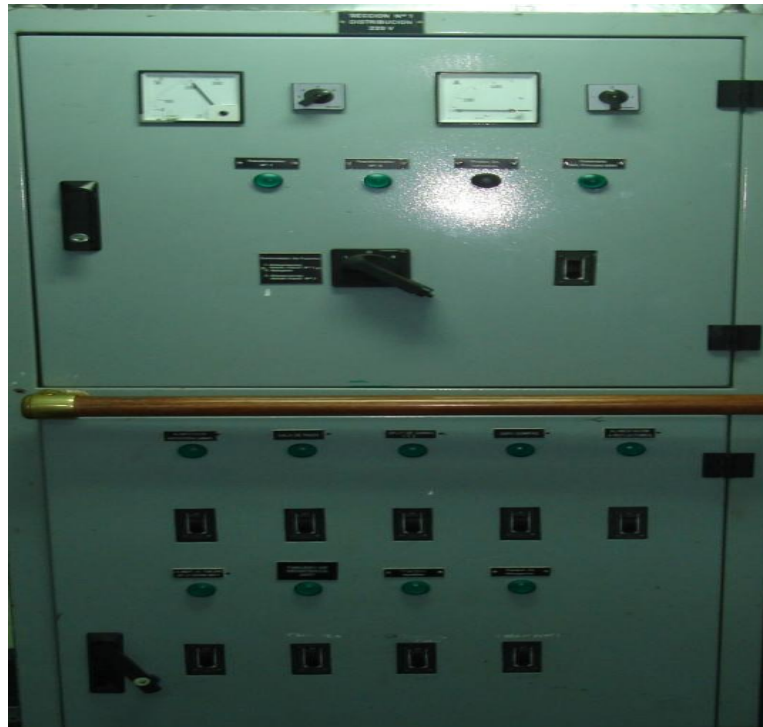
Figura 3-16 Tablero#1 220V Fuente: (CD de memorias del Buque Escuela Guayas, 2005)
