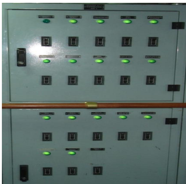
Figura 3-19 Tablero#2 440V Fuente: (CD de memorias del Buque Escuela Guayas, 2005)
