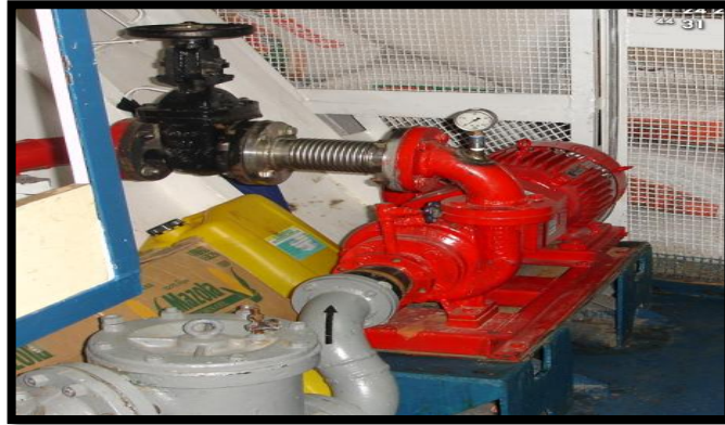
Figura 3-5 Bomba contra incendio Fuente: ( Manual de Ingeniería;Armada del Ecuador)
