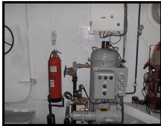
Figura 3-4 Planta de aguas oleosas Fuente: ( Manual de Ingeniería; Armada del Ecuador)
