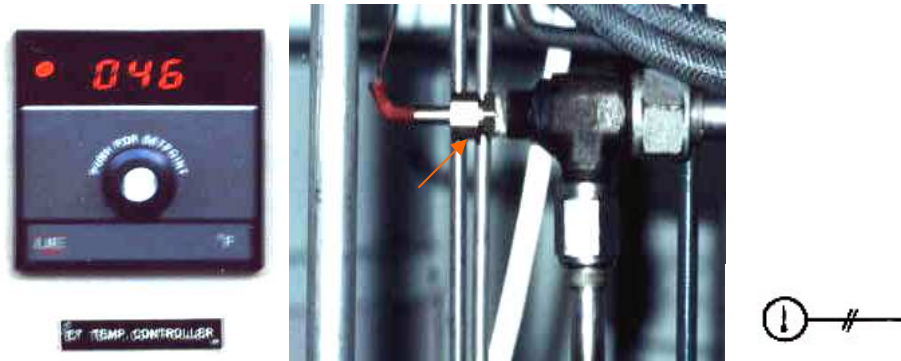
Figura 1.5. Controlador de temperatura (controlador y termocuple)
