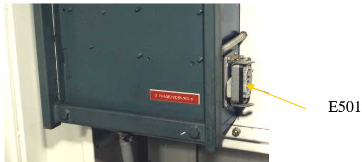
Figura1.33. Enchufe de la caja eléctrica
