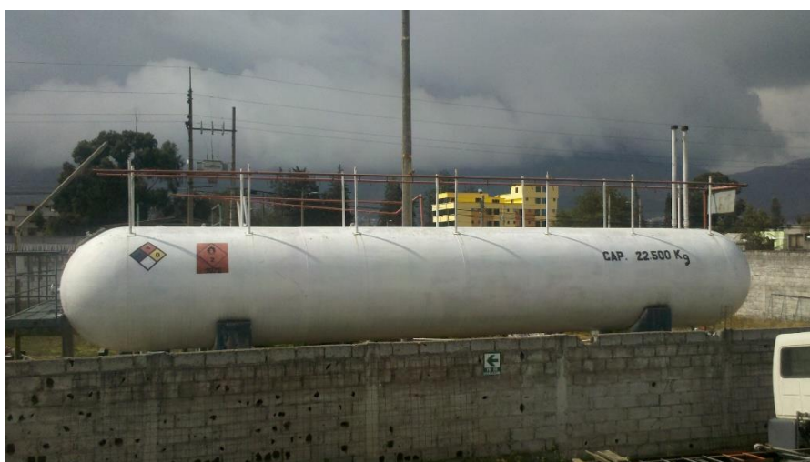
Ilustración 22 Tanques de Almacenamiento vista lateral Fuente: CONGAS Elaborado por: Christian Godoy
