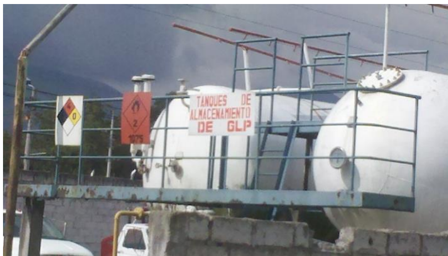
Ilustración 21 Tanques de Almacenamiento vista frontal Fuente: CONGAS Elaborado por: Christian Godoy
