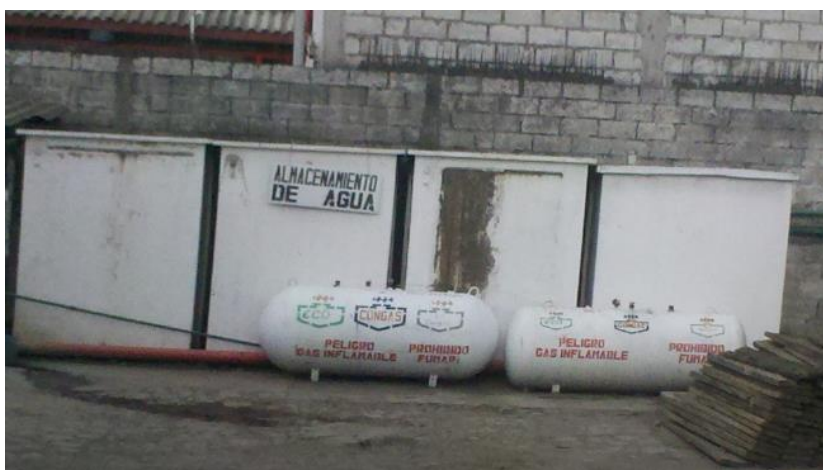
Ilustración 24 Tanques de agua para emergencias Fuente: CONGAS Elaborado por: Christian Godoy
