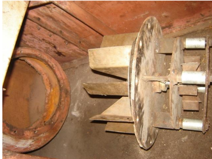
Imagen 4 VENTILADOR PARA FORZAR LA CONVECCION EN CAMARA DE PAN
