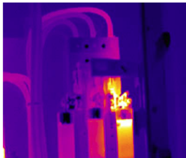
Fig 1. Imagen térmica de un conector eléctrico
