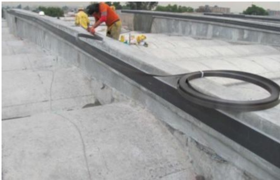
Figura 5: Colocación de platinas en vigas del techo del estadio Fuente: (Rendón & García, 2013)
