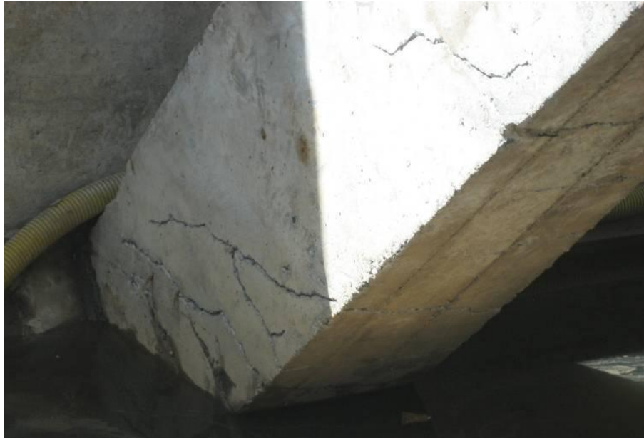
Figura 21: Fisuras en la base de las columnas Fuente: (Rendón & García, 2013)
