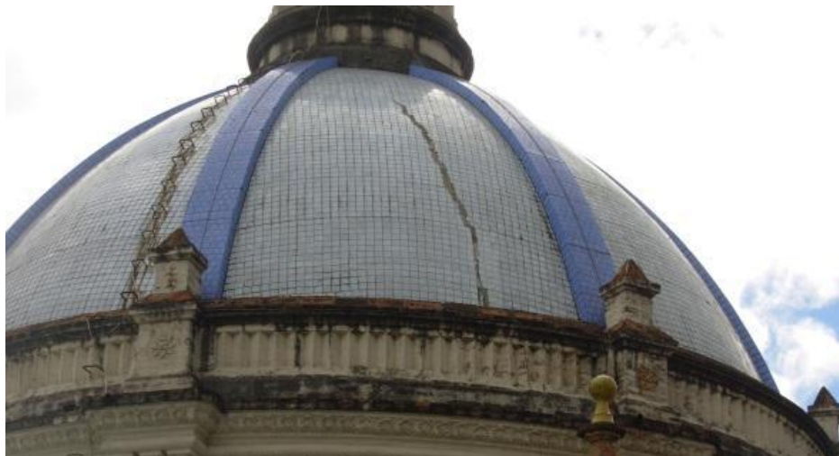
Figura 11: Fisura en la Cúpula de la Catedral de Cuenca Fuente: (Rendón & García, 2013)
