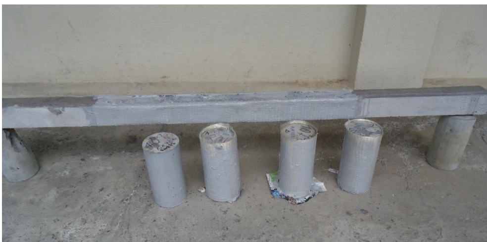
Figura 35: Resultado final de la instalación de la fibra de vidrio SikaWrap Hex 100G Fuente: Elaborado por: Cevallos, Diego
