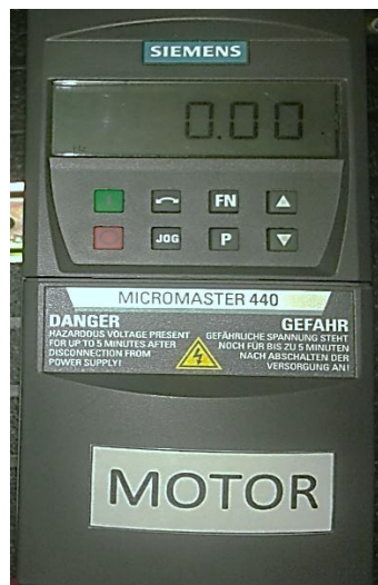
Figura 3.13: Variador de frecuencia del proceso velocidad.
