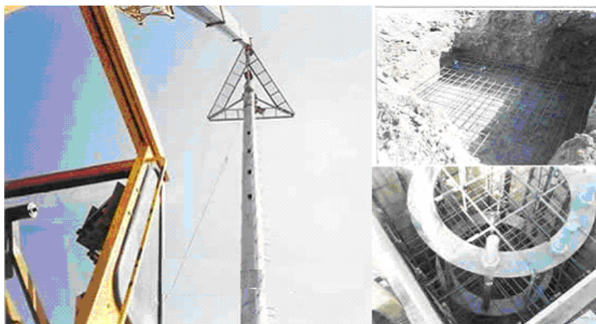
Figura 4.15. Torre tipo monopolo y su cimentación
