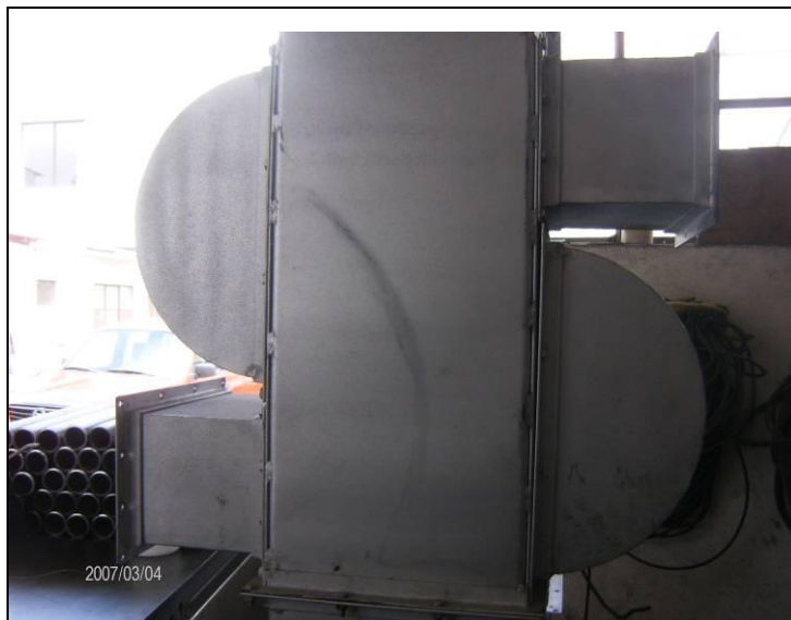
Fotografía 2. Intercambiador de Calor
