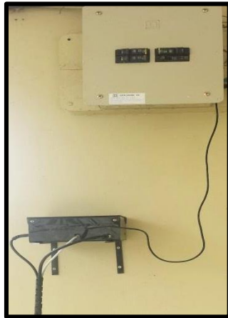
Figura 02a: Etapa de sensado del medidor híbrido
