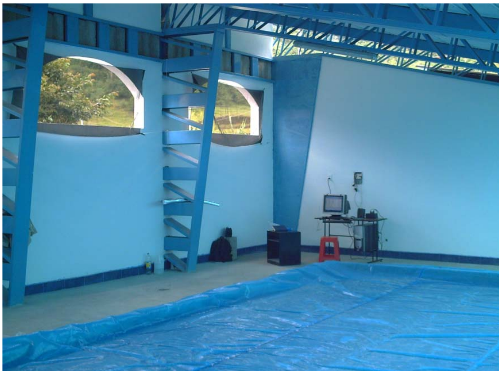
Foto18. Aislamiento mediante la manta térmica sobre la piscina.
