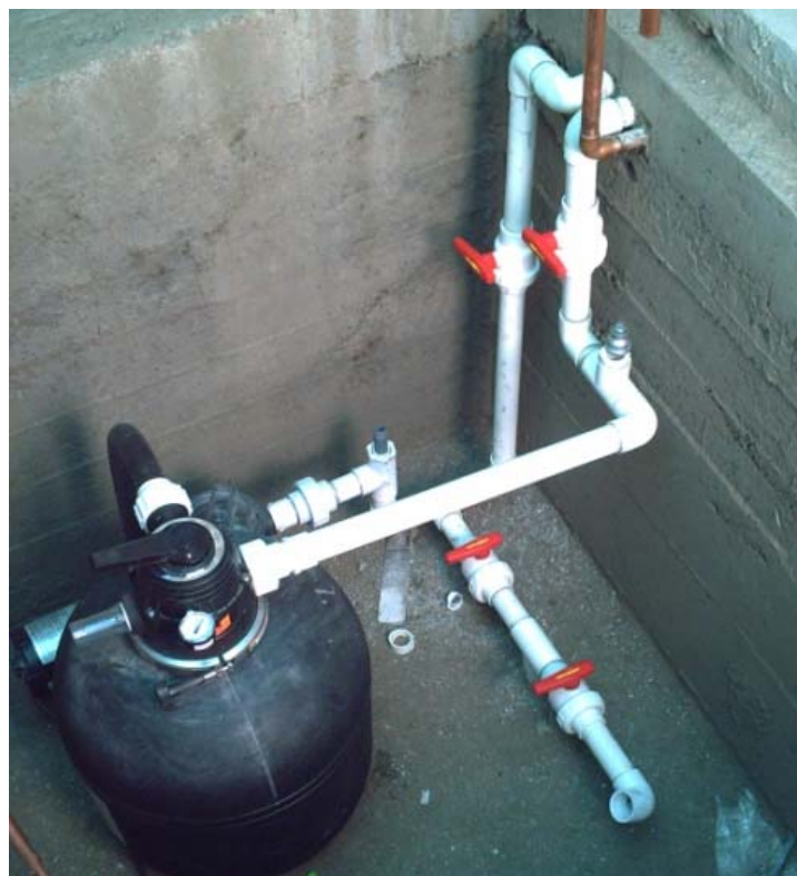
Foto12. Instalación de la bomba, filtro e instalaciones respectivas en la sala de maquinas.
