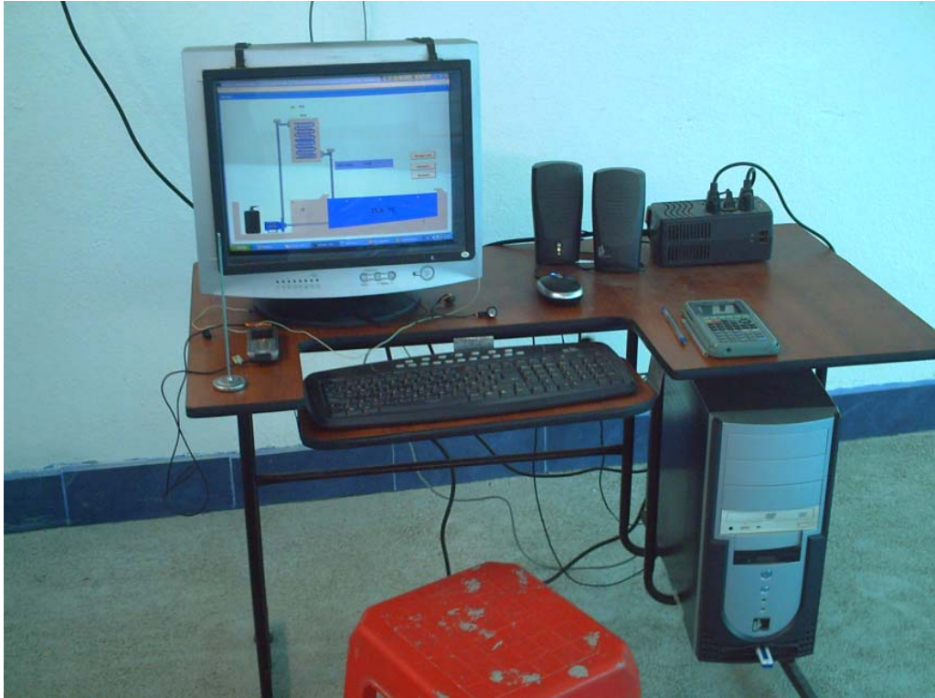
Foto17. Monitoreo del sistema de climatización.
