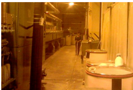
Fig. 1. Se realiza el tendido del cable en el piso con el fin de evitar que se enrede y facilitar el montaje del cable en la canaleta principal.
