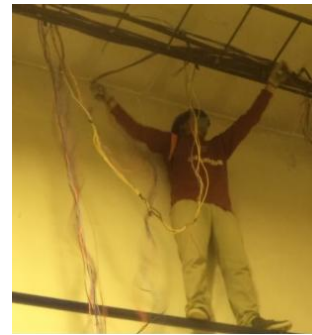
Fig. 2. La fábrica cuenta con una canaleta propia de 50 cm. de ancho para el tendido de cable eléctrico, ubicada en la parte superior de la estructura.
