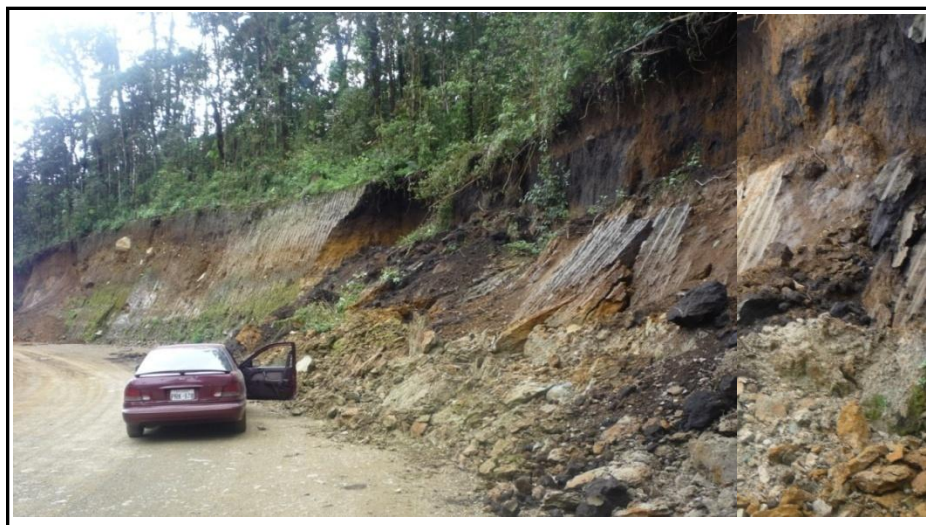
Foto. C.3. Movimiento en masa por fracturamiento y construcción de la vía.
