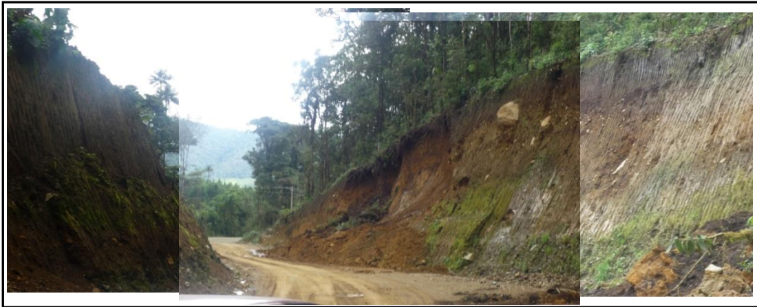
Foto. C.2. Movimiento en masa por meteorización y construcción de la vía.
