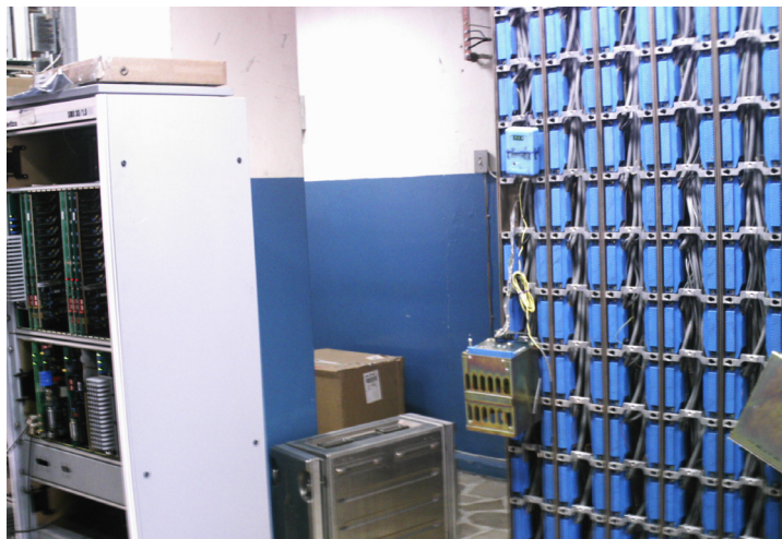
Figura. I.16. Sala Equipos Quito
