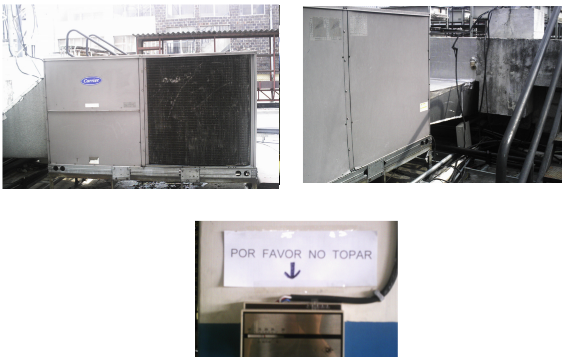
Figura. I.19. Equipo de Aire Acondicionado
