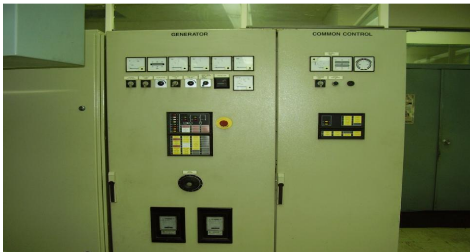
Fotografía 3.3: Tablero de protecciones del grupo generador Wärtsilä Diesel.
