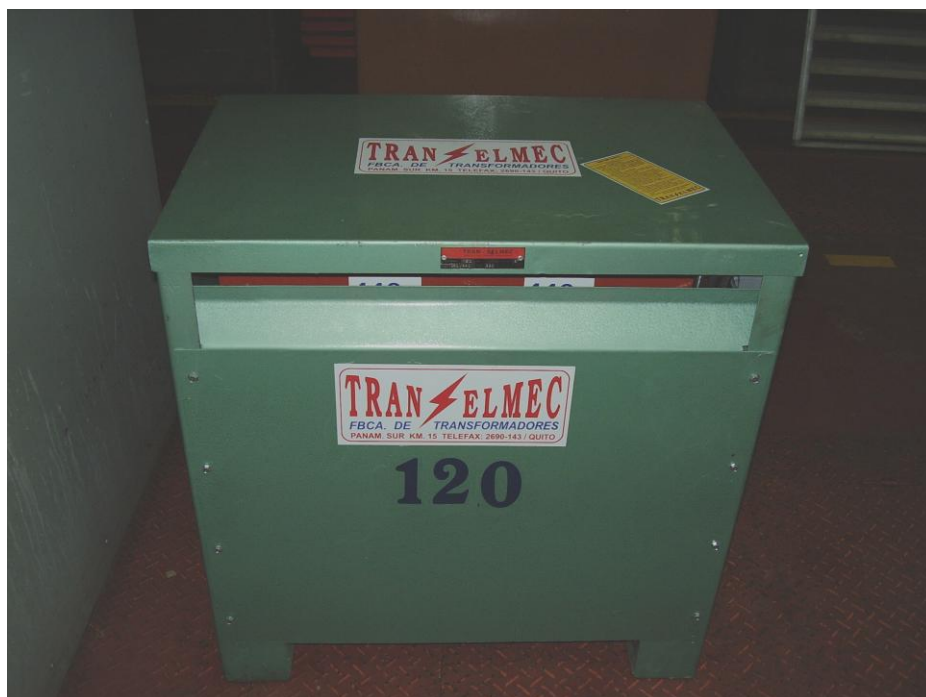
Fotografía 3.4: Autotransformador de elevación de 380V a 440V.
