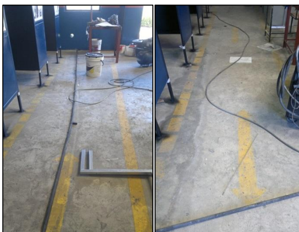
Figura 4. 2: Pisos en mal estado
