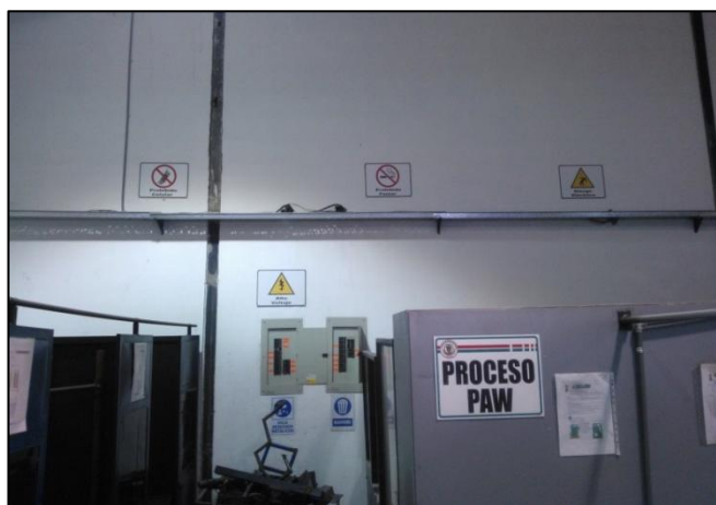
Figura 4. 3: Paredes en mal estado
