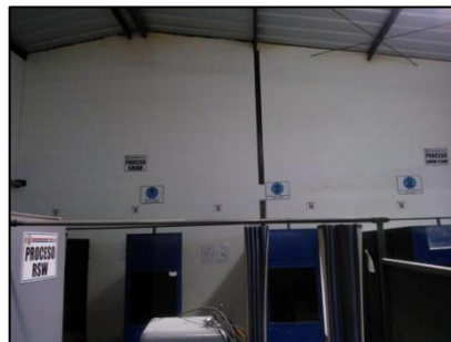
Figura 4. 28: Paredes en mal estado del laboratorio
