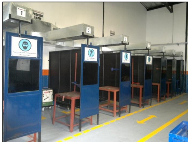
Figura 4. 40: Señalética de seguridad implementada
