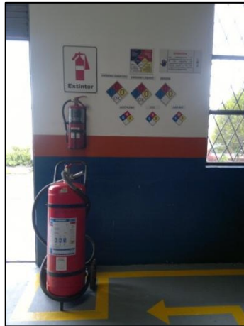
Figura 4. 39: Implementación de la señalética de seguridad y precaución
