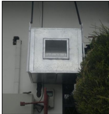
Figura 4. 31: Manejadora de extracción humo industrial
