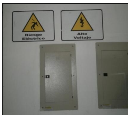
Figura 4. 46: Señalización de prohibición colocada
