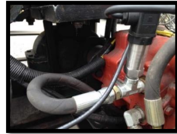
Figura 15: Implementación de los sensores de presión aceite hidráulico.
