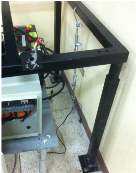
Figura 32. Templador adicionado a la base del elevador
