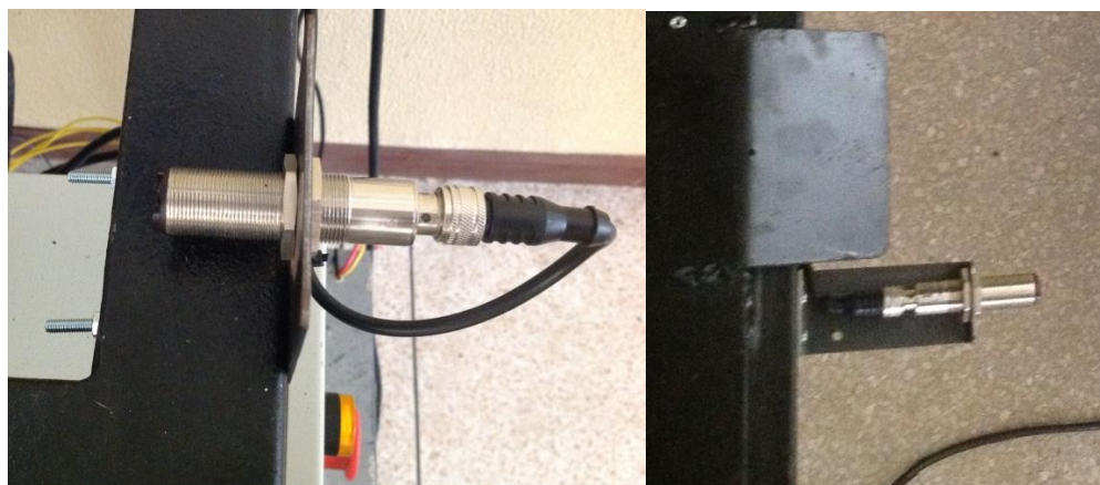
Figura 130. Implementación sensores fotoeléctricos IBEST
