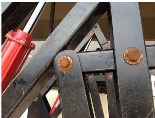
Figura 43. Rozamiento de los brazos al plegarse la plataforma
