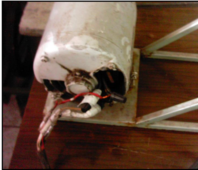
Figura 3.1. Condiciones en las que se encontró el motor eléctrico.
