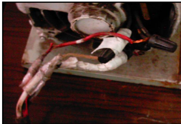
Figura 3.2. Cables de motor eléctrico en mal estado
