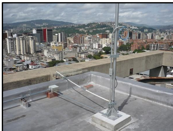
Figura 37. Mástil para antenas.
