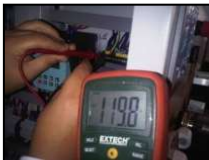
FIGURA 4.3. Medición Voltaje de alimentación del PLC
