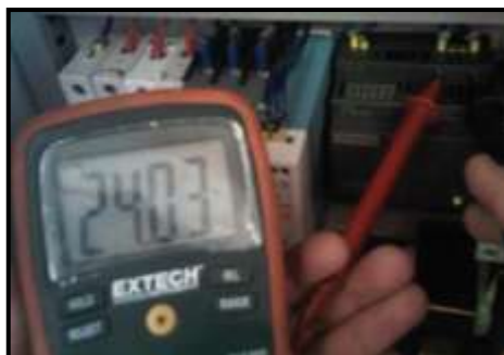
FIGURA 4.5.Verificación de voltaje de salida de fuente Siemens
