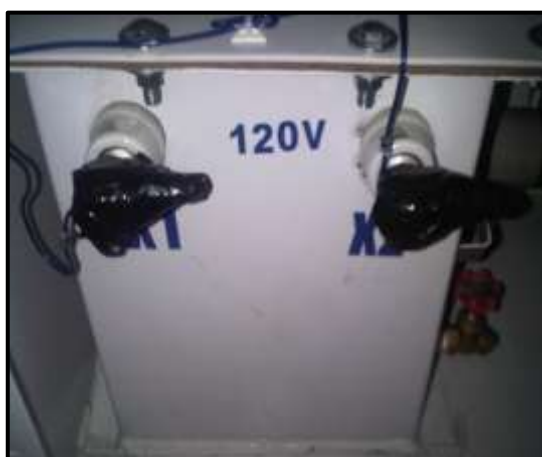
FIGURA 3.19. Cara frontal del transformador
