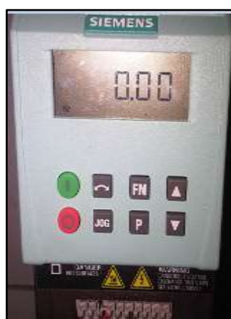
FIGURA 3.10. Variador de frecuencia
