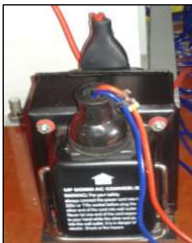
FIGURA 3.9. Cableado de transformador
