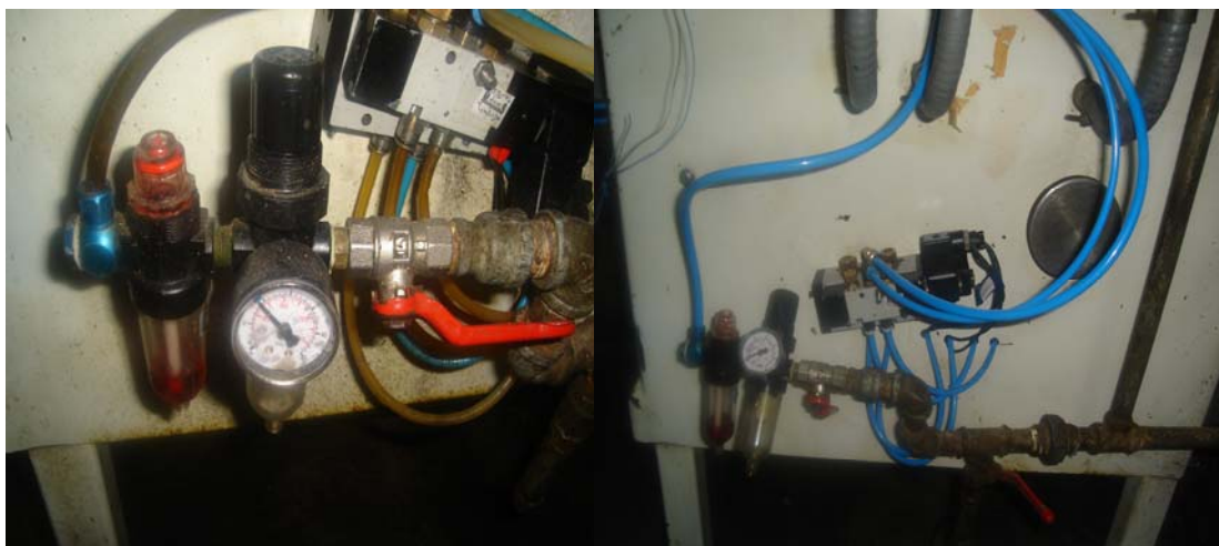
Figura 5.10. Red de distribución neumática
