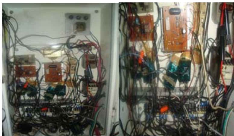
Figura 5.1. Sistema de control antiguo
