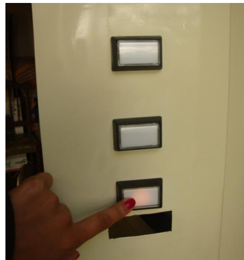
Ilustración 12 Pulsadores en la puerta principal del armario metálico
