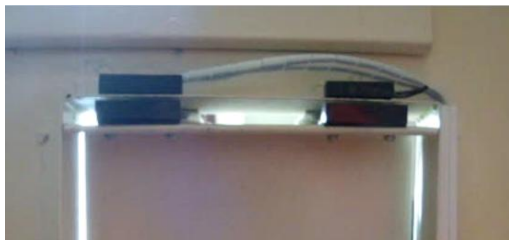
Ilustración 13 Ubicación de los sensores en la puerta de expendio
