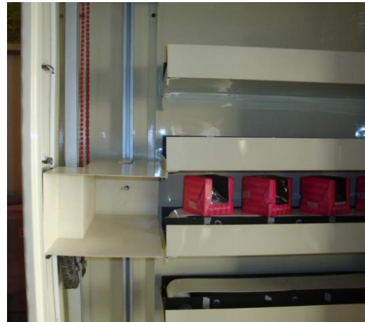
Ilustración 11 Ubicación de los interruptores magnéticos
