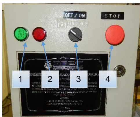
Figura 3.1: Tablero de control: exterior 144 .
