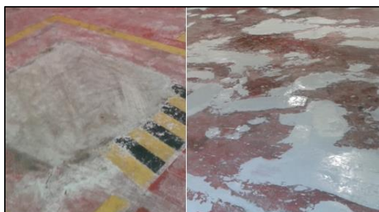
Figura No. 12: Eliminación de grietas y agujeros. Autores: Ayala A. Mogro A.
