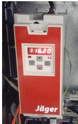
Figura 3. 6: Variador de frecuencia y velocidad.
