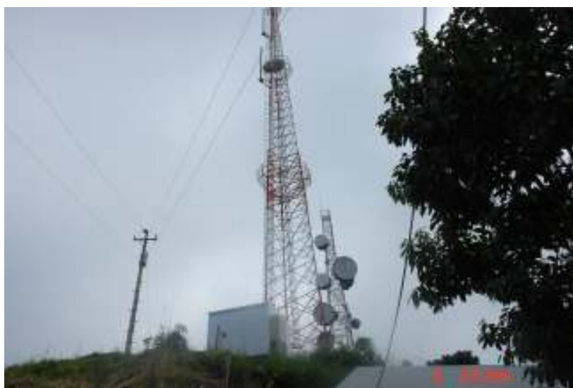
Figura. 6.39. Torre Autosportada de 45 metros.
