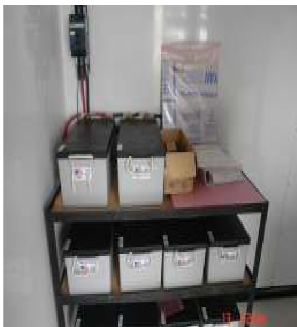
Figura. 6.19. Sistema de Baterías.
