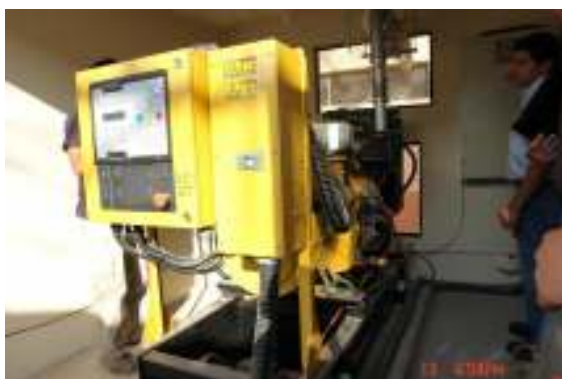
Figura. 6.41. Generador Bifásico de 20 KVA.
