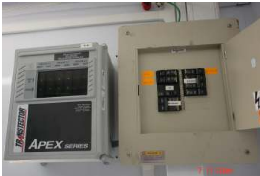
Figura. 6.4. Supresor de Transientes, Panel de Breaker AC.
