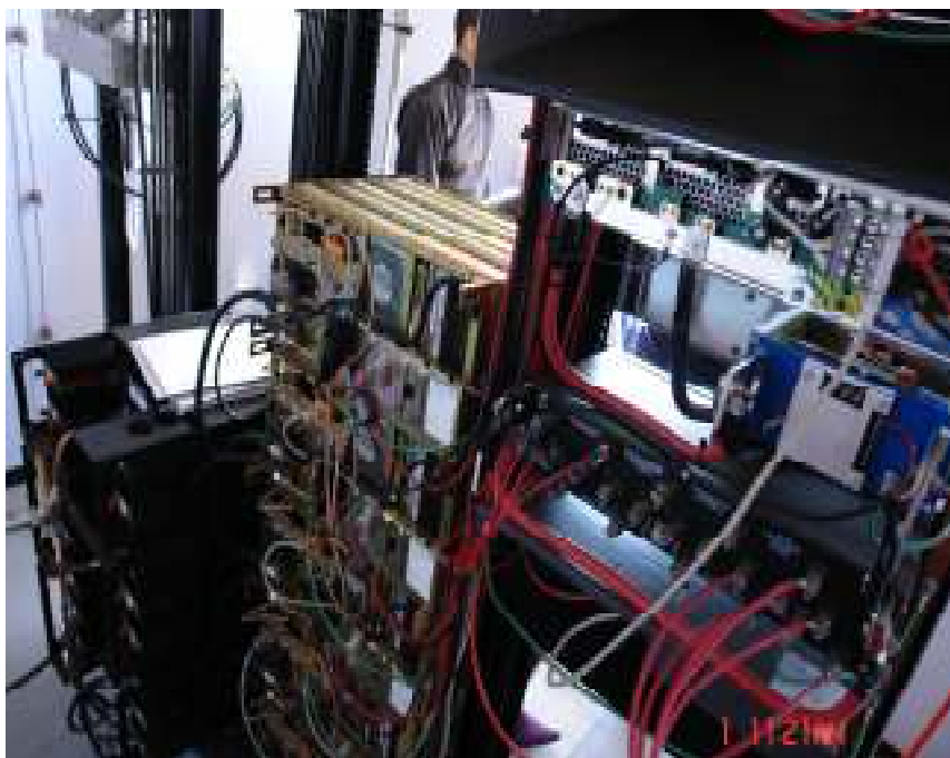
Figura. 6.18. Vista posterior de Repetidores y Sistema de Energía.
