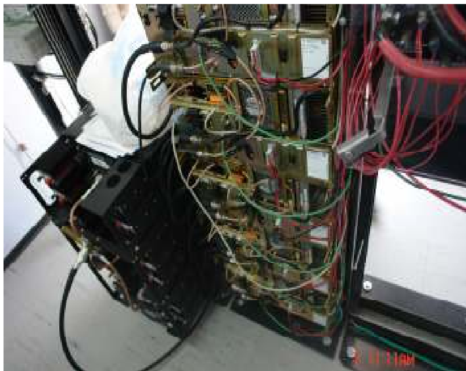
Figura. 6.5. Combinador, Repetidor parte posterior.
