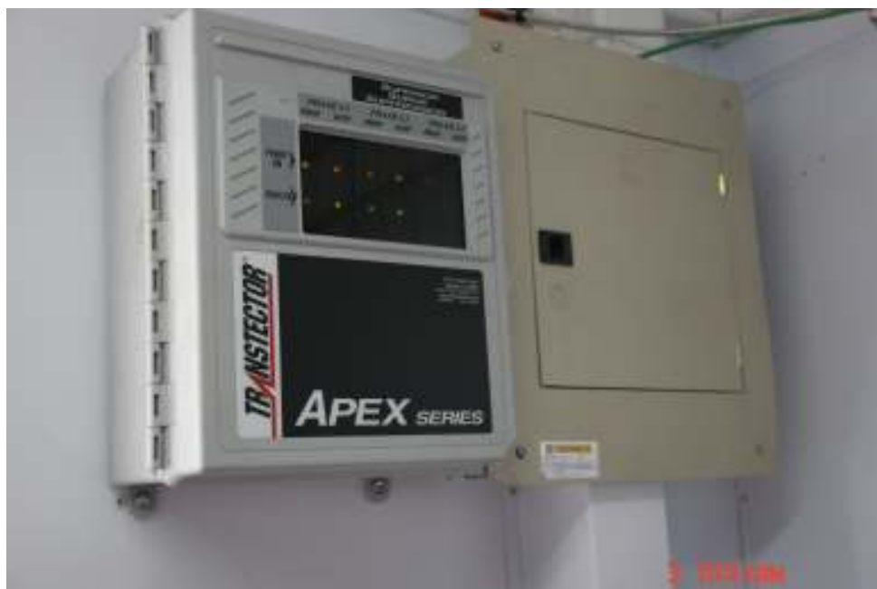
Figura. 6.27. Protector de Transientes y Panel de Breakers AC.
