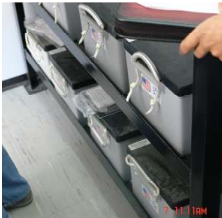
Figura. 6.7. Banco de Baterías.
