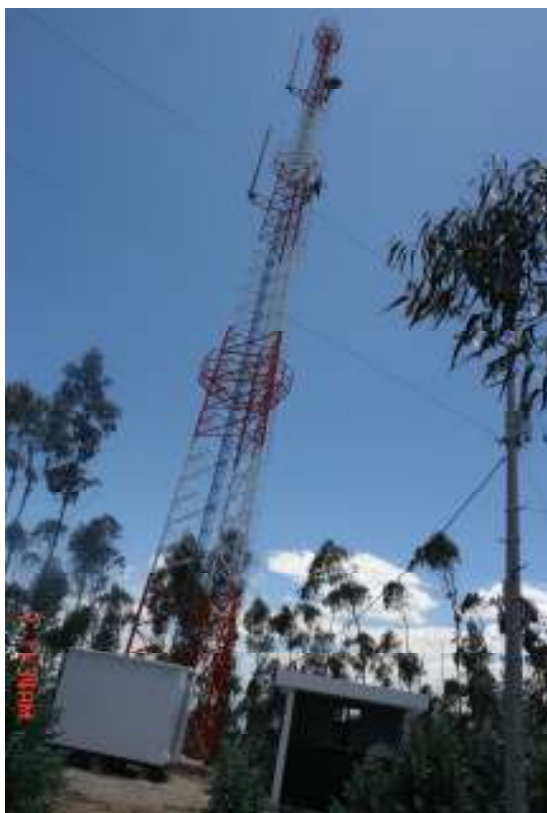
Figura. 6.14. Infraestructura completa: torre, shelter, caseta generador, antenas.
