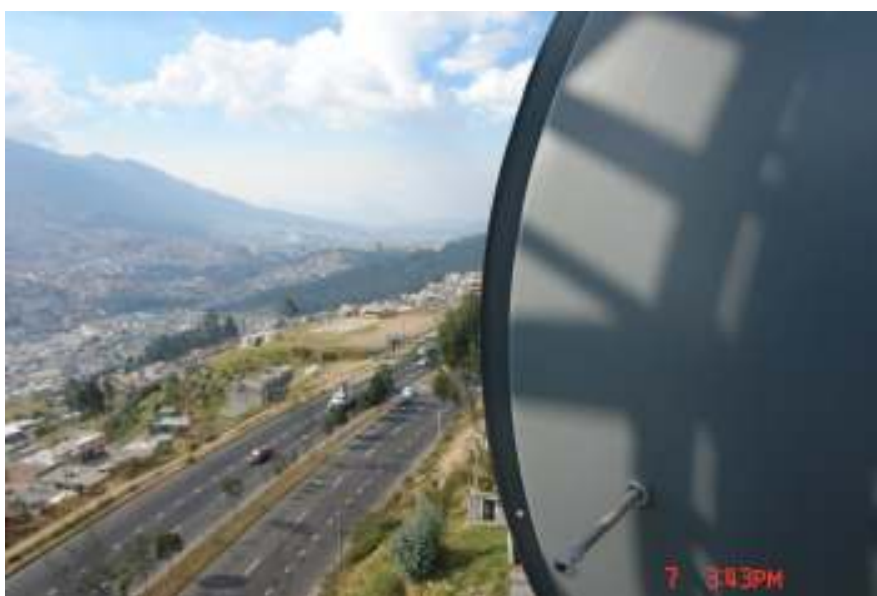
Figura. 6.46. Antena Parabólica. Enlace Puengasí – Mitaloma.
