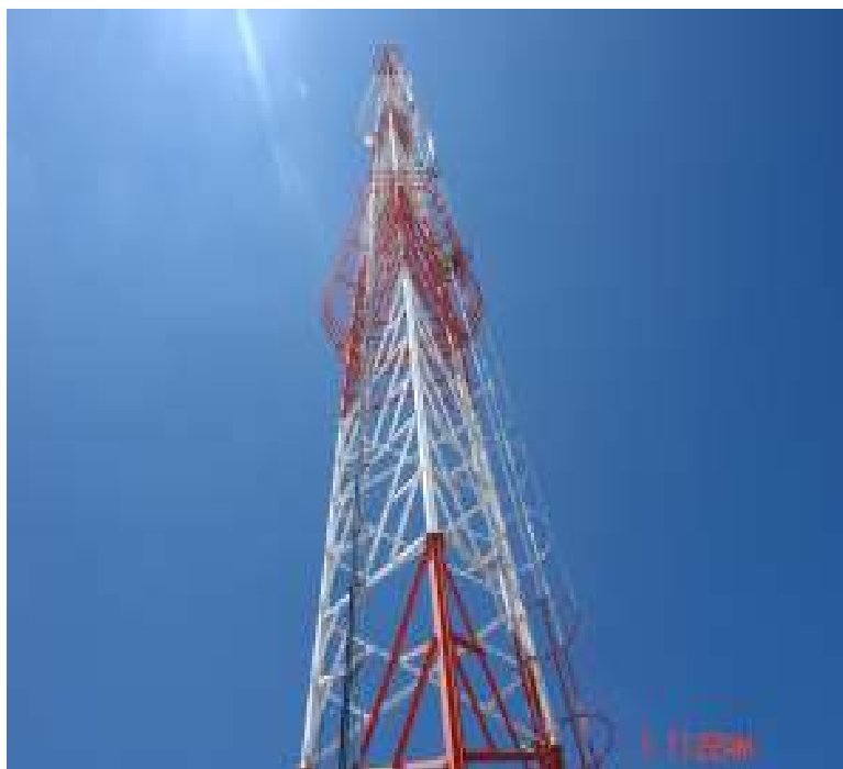
Figura. 6.20. Torre Autosportada de 45 metros.
