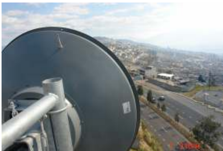
Figura. 6.45. Antena Parabólica. Enlace Puengasí – La Viudita
