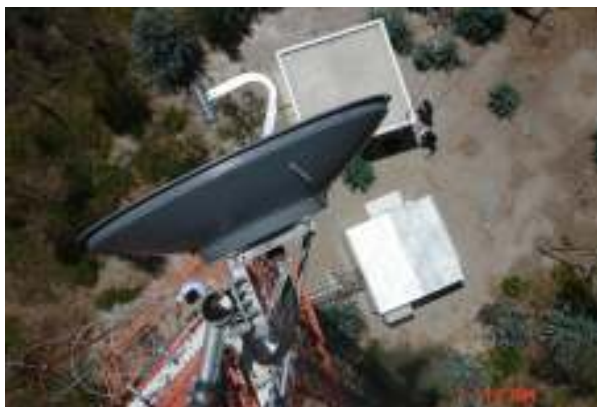
Figura. 6.11. Antena Parabólica, enlace Mitaloma – Monteserrín.
