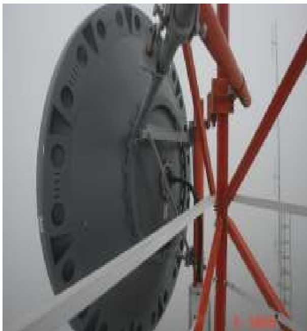
Figura. 6.21. Antena Parabólica, Enlace Monteserrín - Mitaloma.
