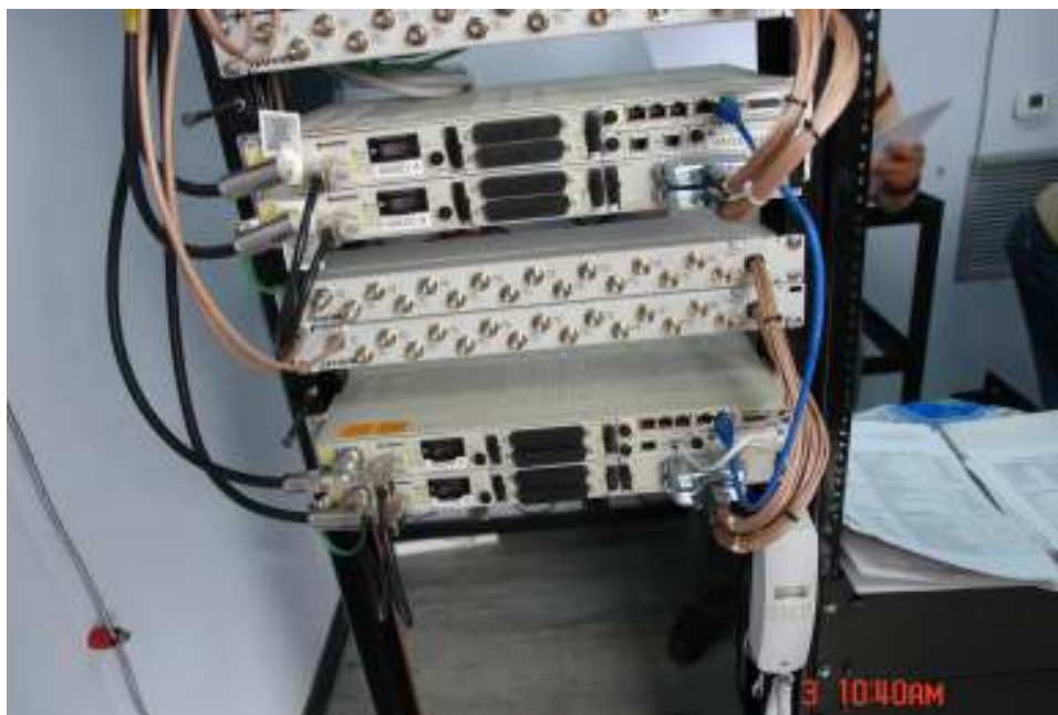
Figura. 6.24. Sistema de Microonda. Enlaces: La Viudita – Yamboya, La Viudita – Puengasí.
