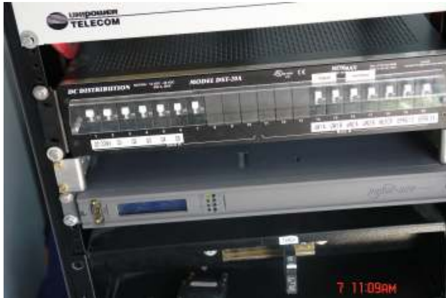
Figura. 6.1. Sistema de Energía: Controlador, LVD, Panel de Breakers.
