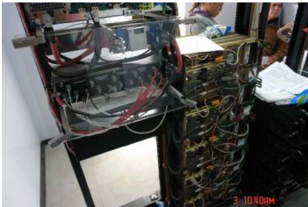
Figura. 6.26. Vista Posterior, Sistema de Repetición y Sistema de Energía.
