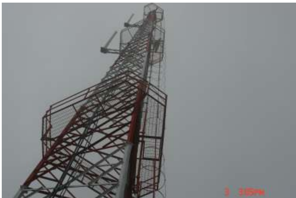
Figura. 6.33. Torre Autosoportada de 42 metros.
