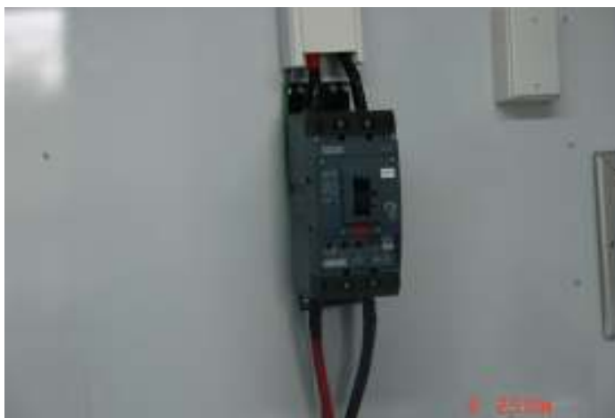
Figura. 6.37. Breaker de protección para conexión de banco de baterías.
