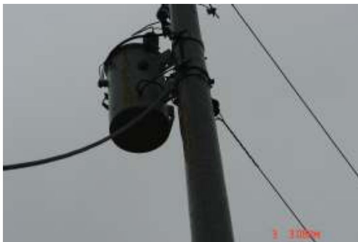
Figura. 6.34. Acometida Eléctrica AC.
