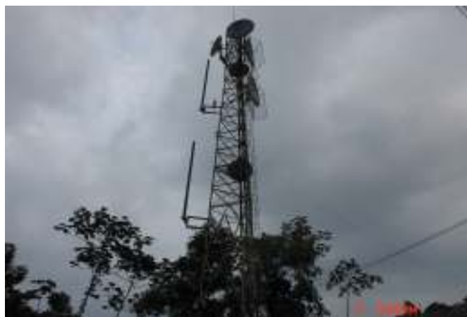
Figura. 6.42. Antena Parabólica, enlace Bombolí – Cerro de Osos.
