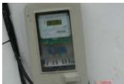
Figura. 6.40. Medidor de Bifásico de Energía de la Red Comercial.
