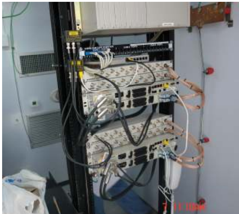
Figura. 6.3. Sistema de Microonda: Mitaloma - Puengasí, Mitaloma - Monteserrín. Sistema de Multiplexación: Tenser.
