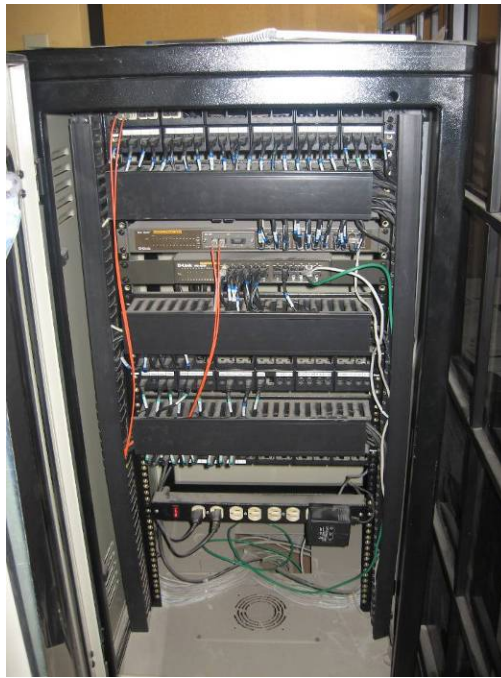
Figura. 3.15. Rack Secundario C-T-P3 en Obras Públicas
