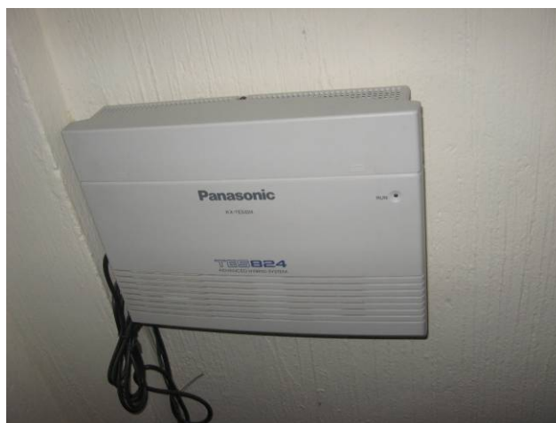
Figura. 3.38. Central telefónica Unidad de Tránsito
