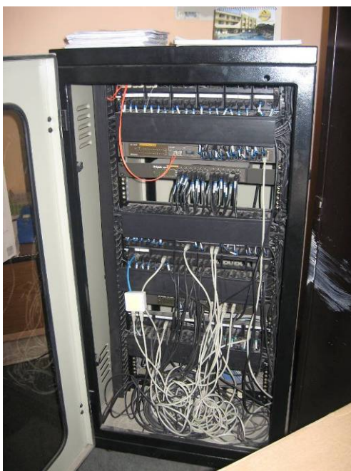
Figura. 3.13. Rack C-T-PB Secundario en Tesorería
