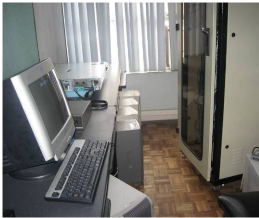
Figura. 3.11. Cuarto de Comunicaciones
