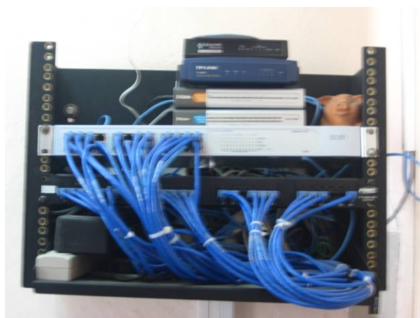
Figura. 3.33. Equipos de datos en el hospital
