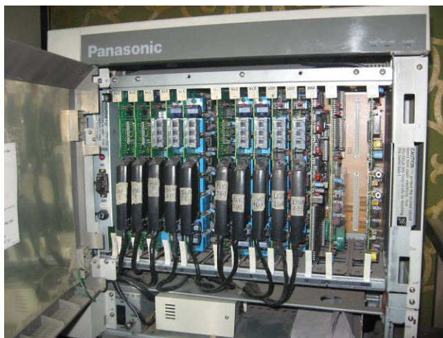
Figura. 3.36. Central telefónica Edificio Matriz
