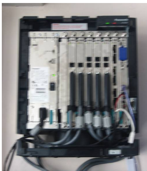
Figura. 3.39. Central telefónica Hospital Municipal
