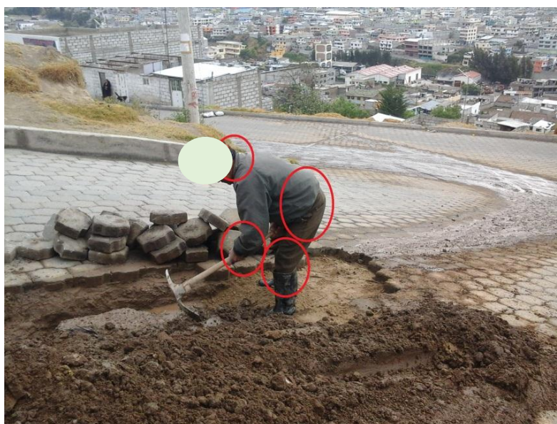
Figura Nº 4.16: Zonas afectadas en el cargo de Plomero de Agua. Fuente: Carvajal, V.; León, S. (2014).
