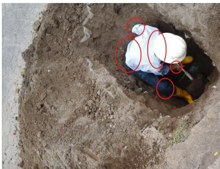
Figura Nº 4.21: Zonas Afectadas en el Cargo de Plomero de Alcantarillado. Fuente: Carvajal, V.; León, S. (2014).
