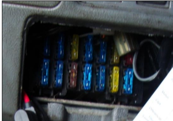
Figura 80: Pines de fusible
