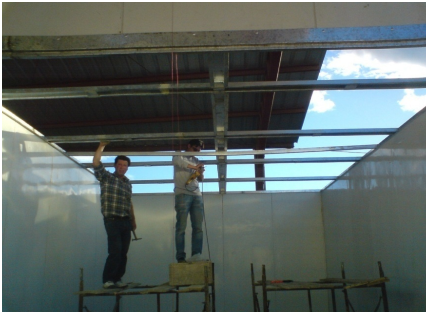
Ubicación de los refuerzos
