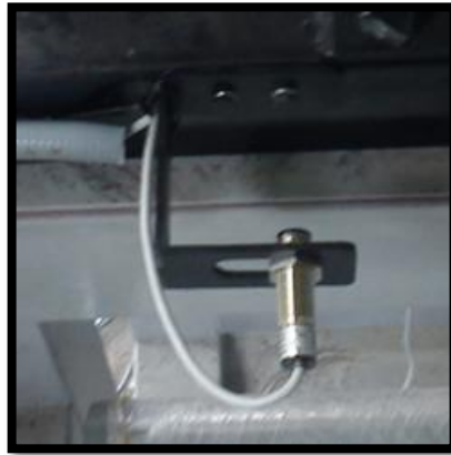
Figura 127. Placa empernada a la base y sensor ubicado en la misma.
