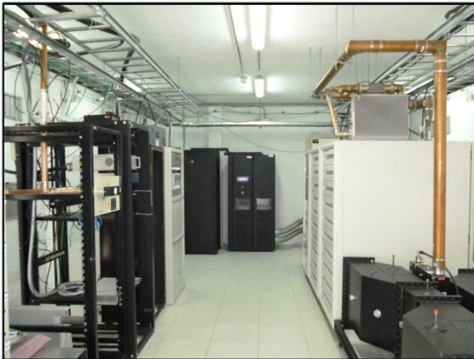
Figura 2.12: Vista interior de la caseta de transmisión de ECTV. (Fotografía tomada en la estación de ECTV, 2013)
