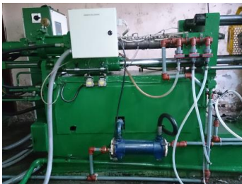
Figura 7. Circuito de enfriamiento de fluido hidráulico y moldes
