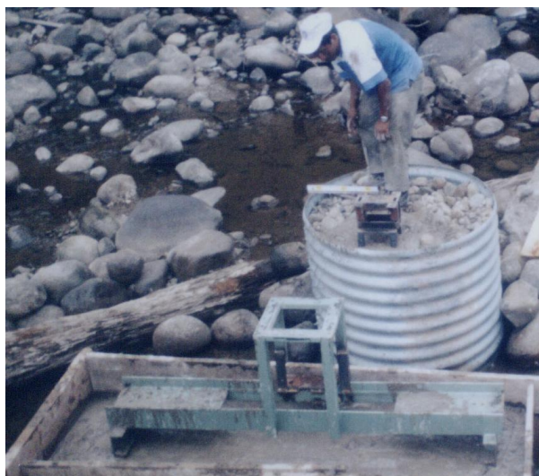
Figura 4.18 Anclaje de los bastidores
