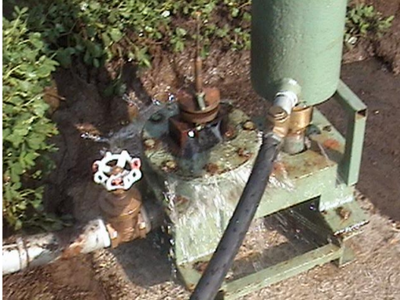
Figura 5.14 Ariete hidráulico funcionando.
