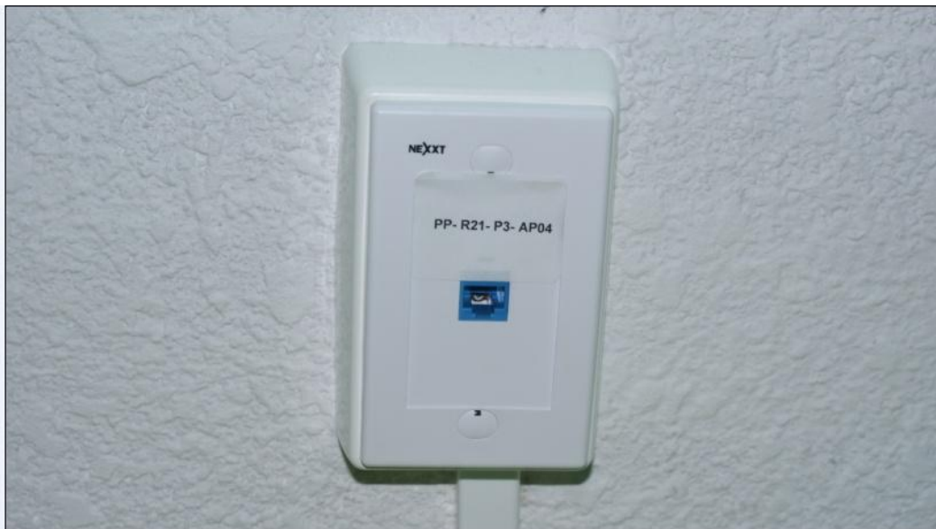
Figura. 7.41. Punto de red CAFDER_PISO1b
