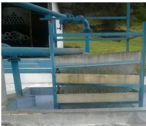
Figura 36. Filtración del agua..
