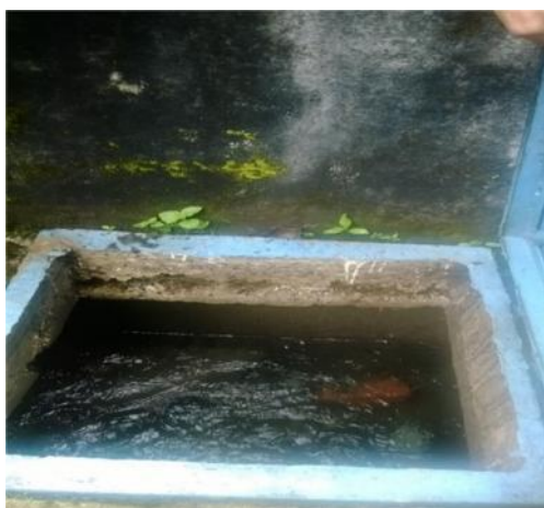
Figura 33. Cámara de captación del agua cruda.
