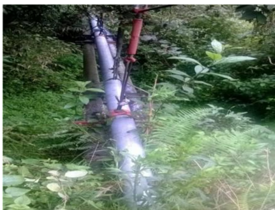
Figura 34. Conducción aérea del agua.
