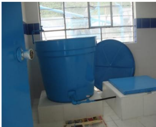
Figura 37. Tanque de desinfección del agua.
