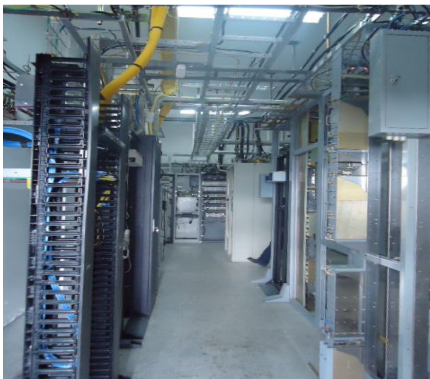
Figura No. 3.10 Infraestructura interna existente Estación Repetidora Cerro Blanco
