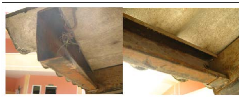
Figura 7: Problemas de corrosión en elementos estructurales
