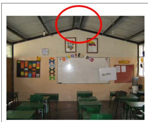
Figura 8: Presencia de goteras en aulas de clase.
