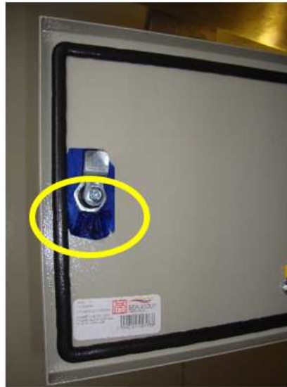
Figura 107 Inspección final puerta gabinete I-0313 - Prueba IPX4
