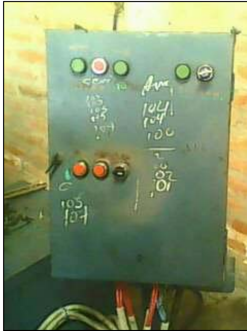
Figura 1.9. Tablero de control original.
