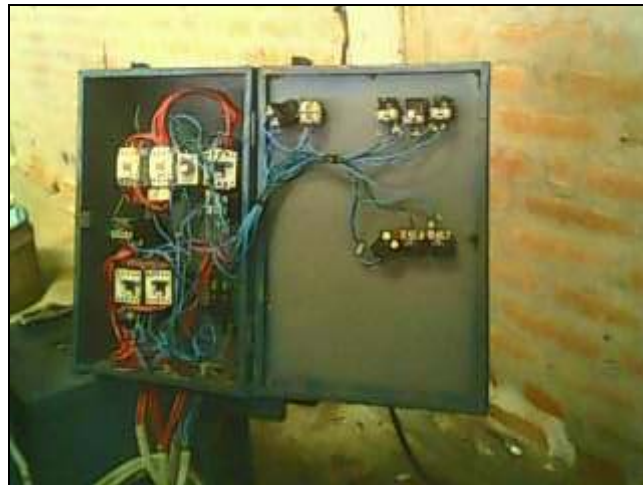
Figura 1.10. Tablero de control original por dentro
