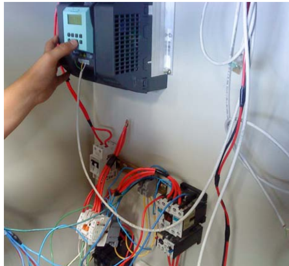
Figura 3.32. Armario y panel con equipamiento instalado junto a la máquina
